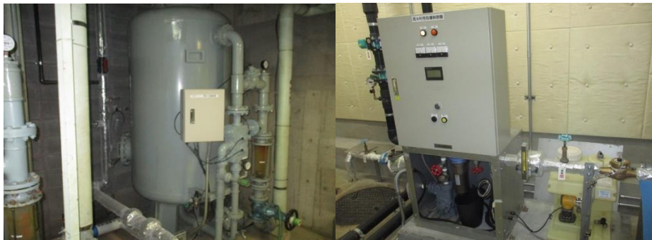
第一校舎 雨水濾過装置
