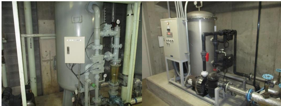
第一校舎 井水濾過装置
