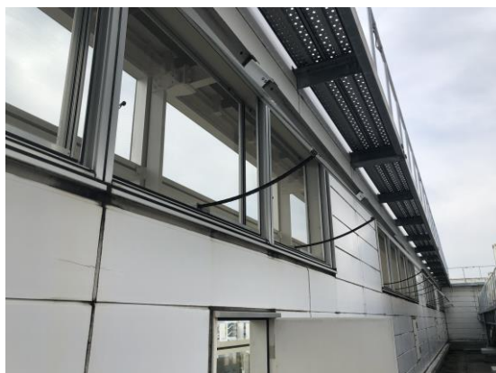
屋上のダンパー（排気口）
