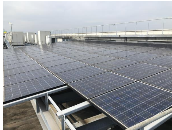
メディア棟 太陽光パネル
