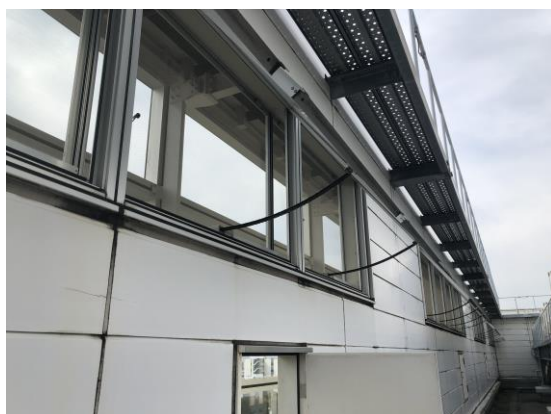
屋上のダンパー（排気口）
