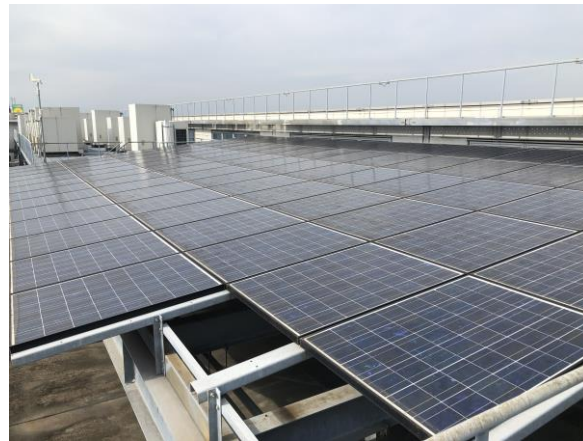
メディア棟 太陽光パネル
