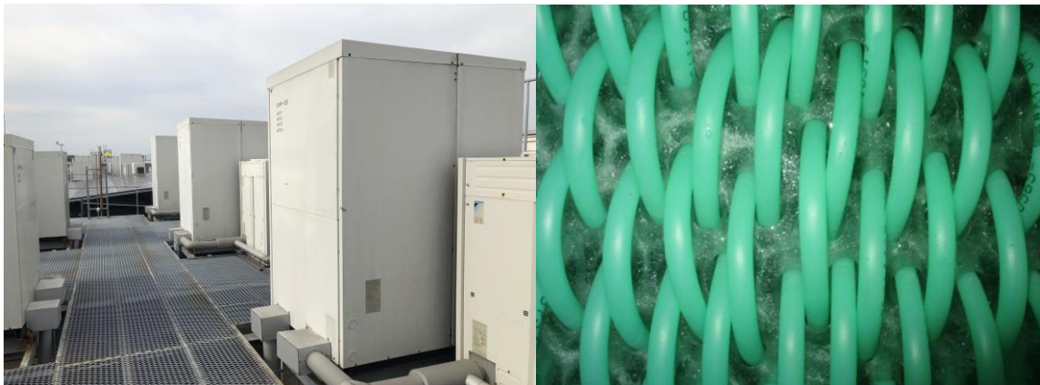
メディア棟 氷蓄熱槽
