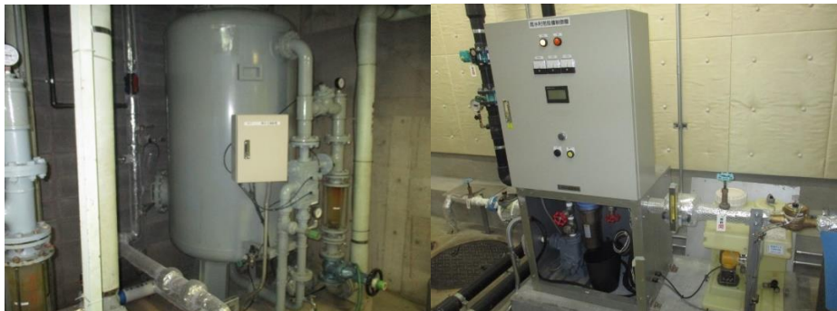
第一校舎 雨水濾過装置
