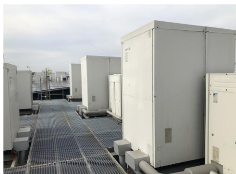
メディア棟 氷蓄熱槽
