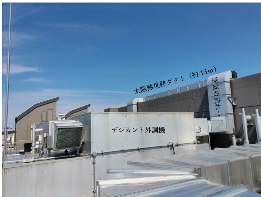
<デシカント外調機および太陽熱集熱ダクト>
