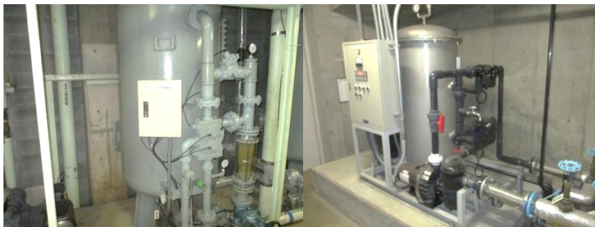
第一校舎 井水濾過装置
