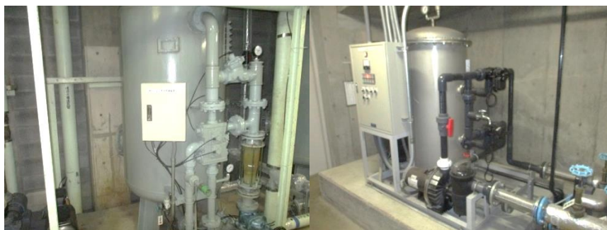
第一校舎 井水濾過装置
