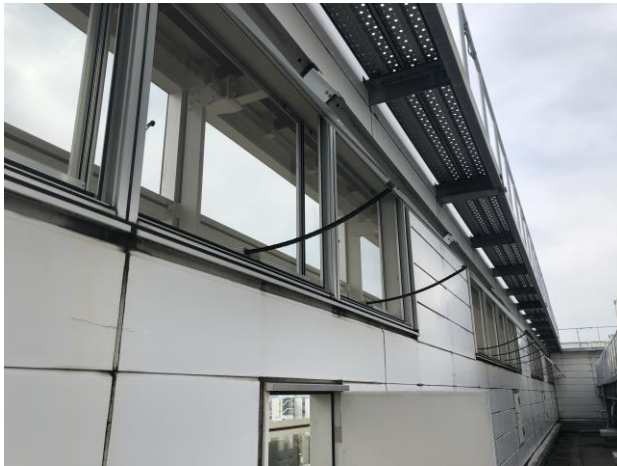
屋上のダンパー（排気口）
