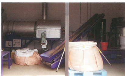
木質ペレット燃料製造施設の一部
